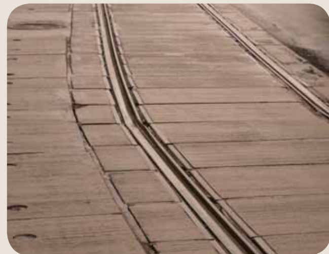
↓ Havarované místo trati.
