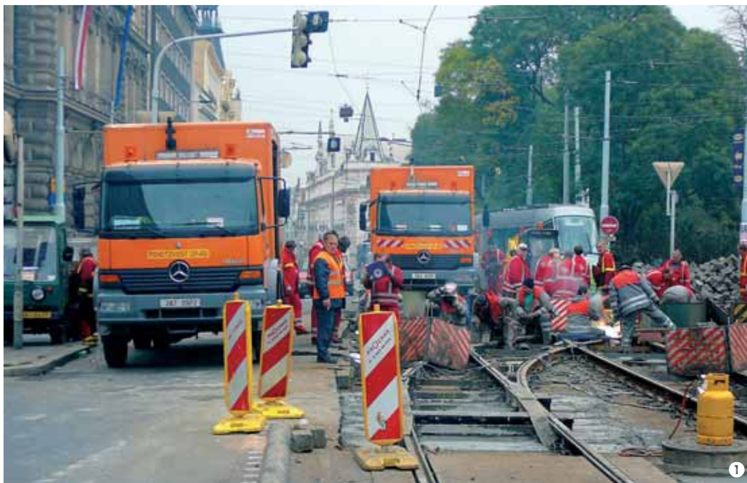
Po svařování nové kolejové konstrukce nastoupili dlaždičci, kteří práce dokončili. Foto © Jan Šurovský
