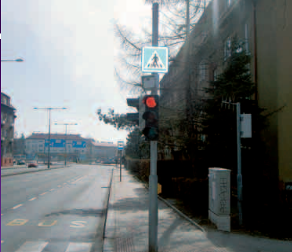
Komunikační IR maják umístěný na křižovatce 8.274 Čimická – Služská, který je určen pro kříž. 8.241 Kobyliské náměstí. V pozadí vpravo je řadič a komunikační jednotka.
