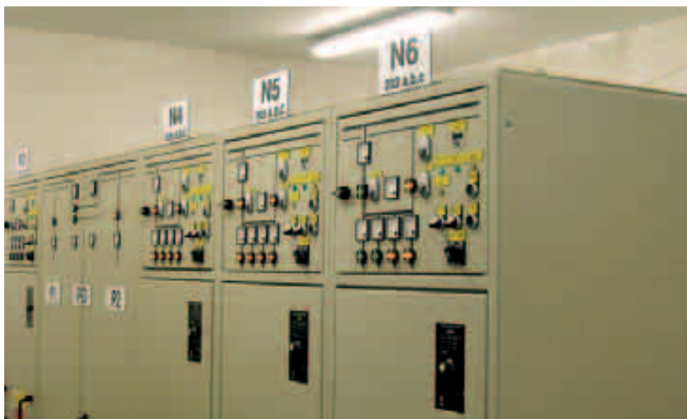
Rozvaděč napáječích kabelů SM Hřebenka.
