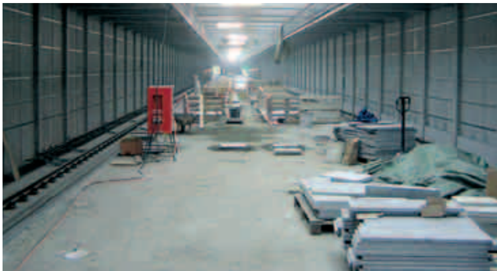
Stanice Depo Hostivař. Foto © Jiří Cudlín
