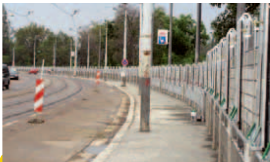
Namontované mobilní hrazení před Holešovickou tržnicí v rámci předání stavby
