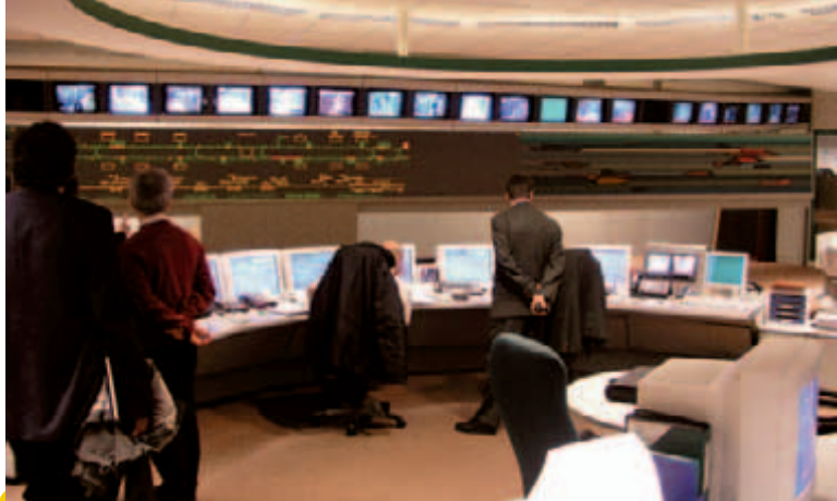
Celkový pohled na řídicí dispečink linky 14. V popředí řídicí počítače operátorů linky, zobrazující nejen technický stav vlakových souprav, ale i stav technologického zázemí tratě (větrání, napájení trakční energií a podobně), v pozadí ve středu je přehledový panel linky a v pozadí nahoře se nachází obrazovky s obrázky nástupišť a s obrázky z prostoru pro cestující libovolné vlakové soupravy na trati.
