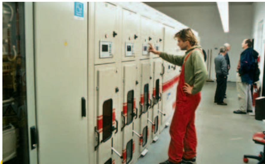
Interiér měniřny Barrandov. Při zkušebních jízdách 1. listopadu se zkoušelo, co se stane při výpadku jedné či druhé měniřny. Tramvaje jezdily i „na jednu měniřnu“.
