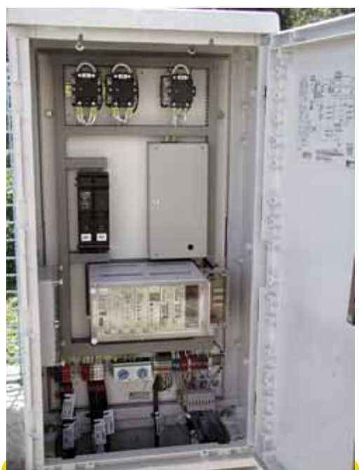
Pohled do řídicí skříně přestavnicku elektricky ovládané výhybky na vjezdu do smyčky Černokostecká.
