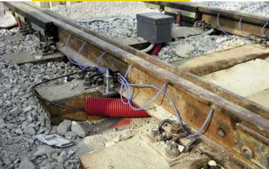
Ve smyčce Černokostecká bylo instalováno mazací zařízení firmy COGIFER. Detail přibližuje rozvod maziiva k jednotlivým mazacím bodům.
